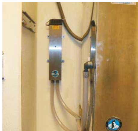
Inbetriebnahme der gereinigten Eismaschine bei Subway Corp.
